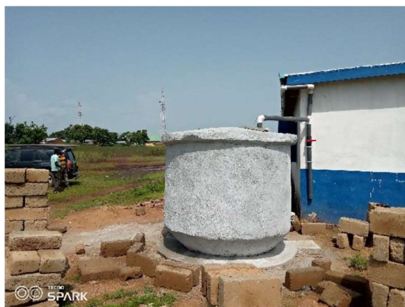
Tank compleet met aansluiting op de dakgoot
